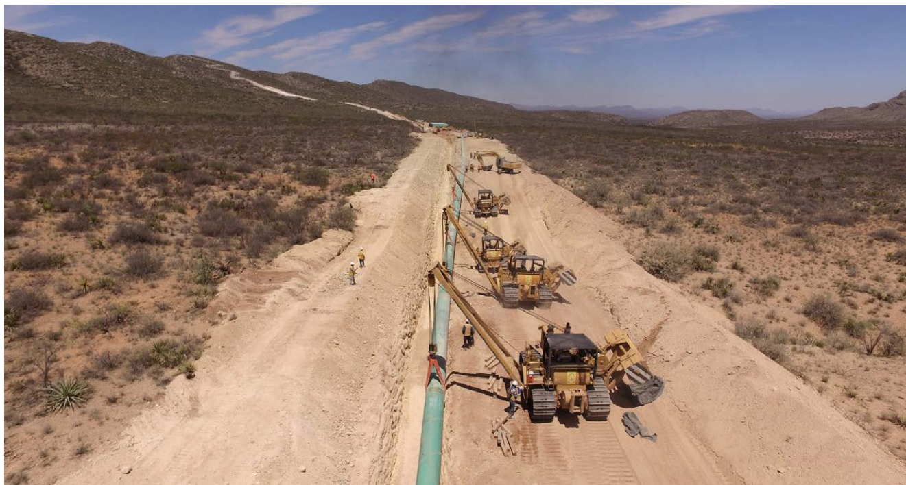
Gasoducto Samalayuca-Sásabe, México.
