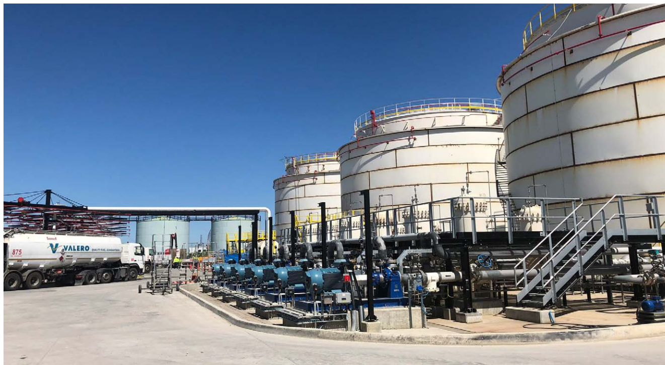
Instalaciones de almacenamiento de combustible del aeropuerto de Dublín, Irlanda.
