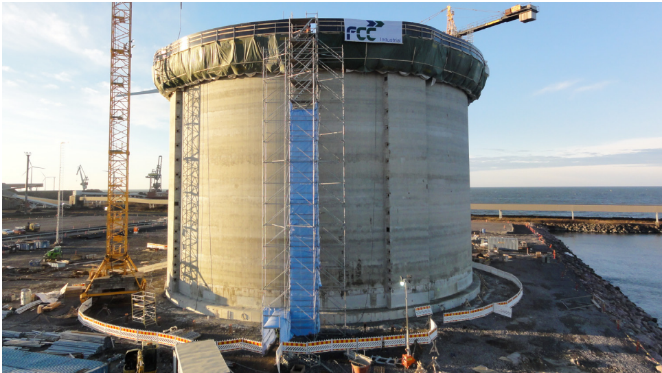
LNG tank in Pori (Finland).
